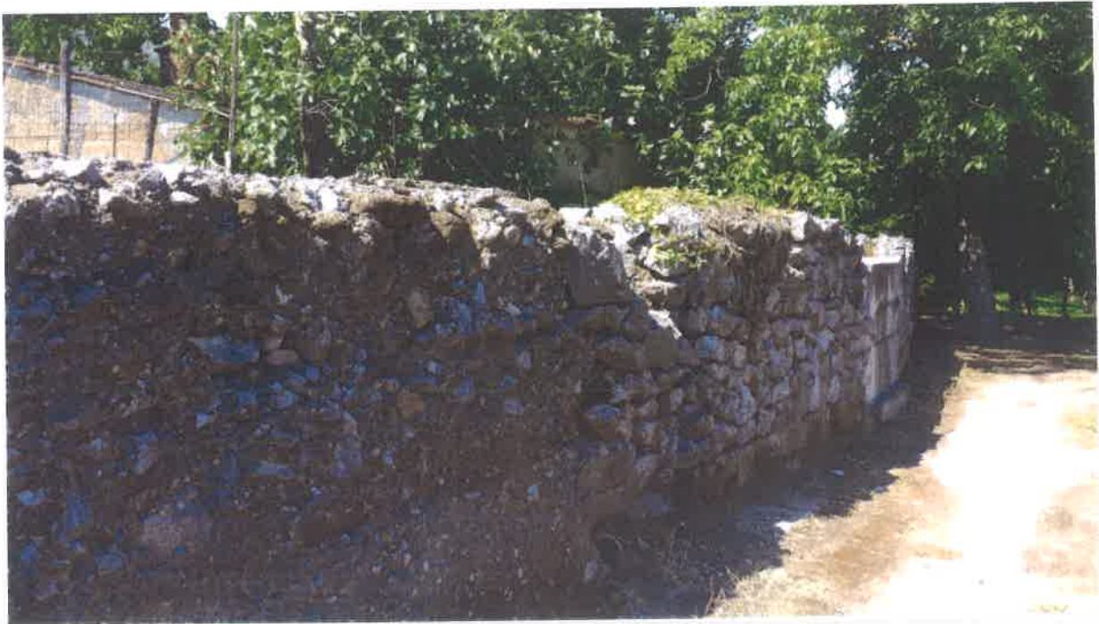
Figura 11: Sponda in destra idraulica del "Rio Secco" (Foto da monte guardando valle)
