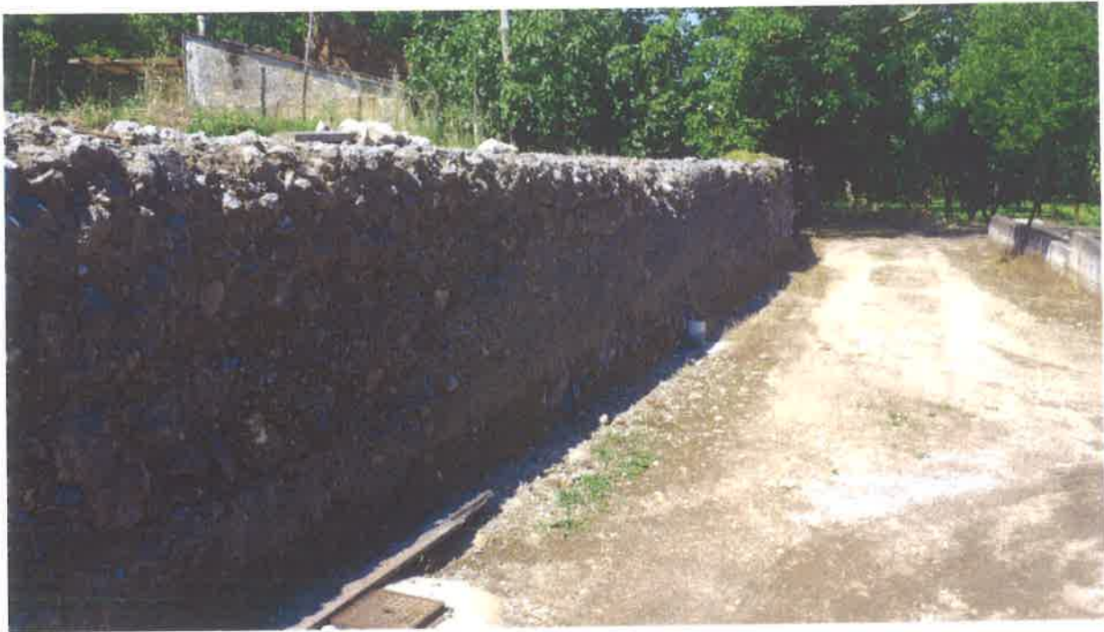
Figura 10: Sponda in destra idraulica del "Rio Secco" (Foto da monte guardando valle)
